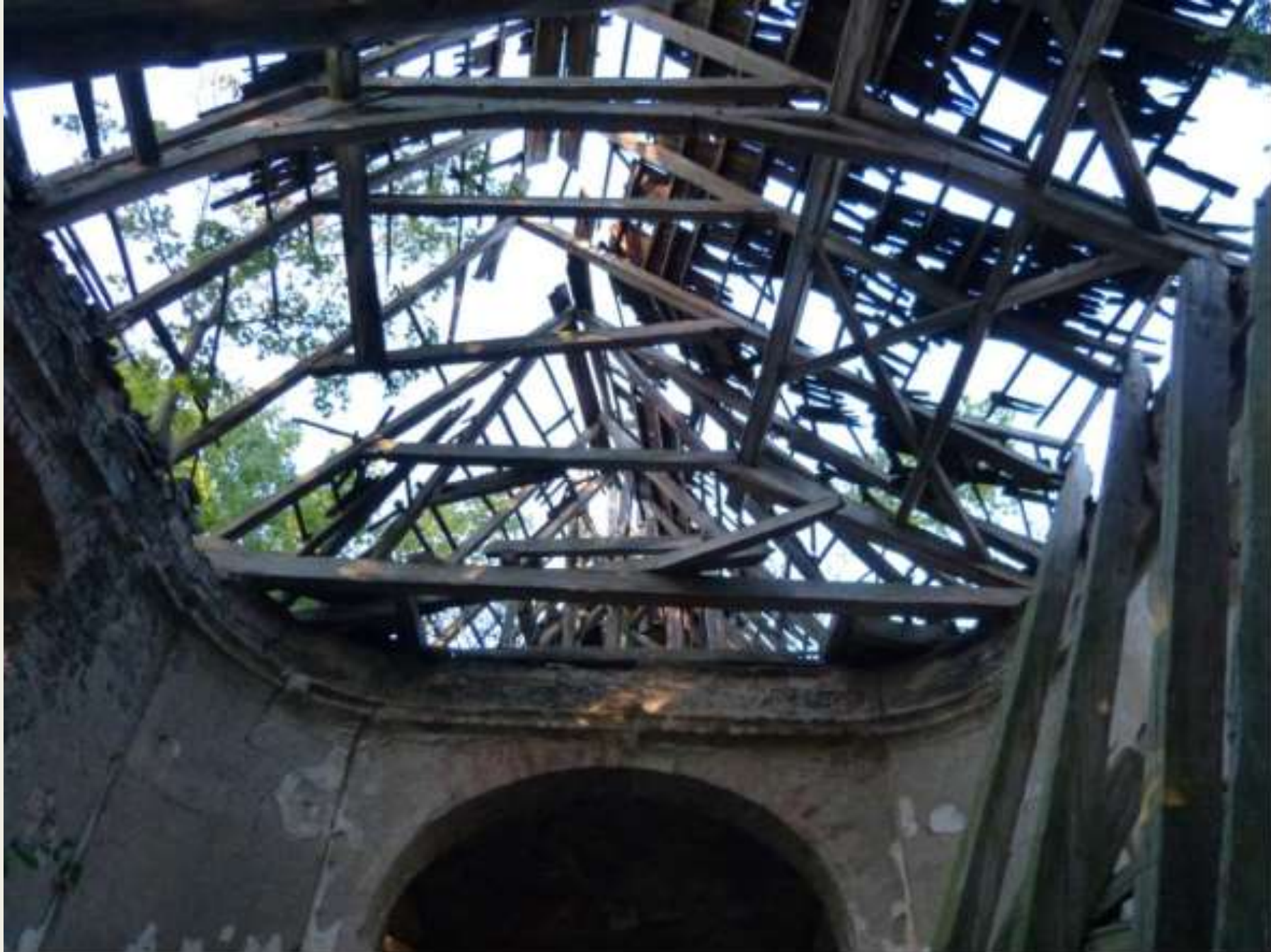
Obrázek 18 - Stav střechy a krovu (2011)
